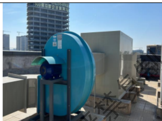
碱液喷淋+活性炭吸附装置
