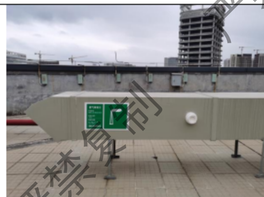
碱液喷淋+活性炭吸附装置（DA001）
